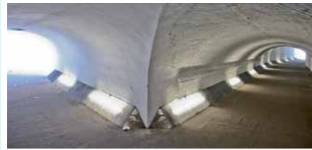
9 Renovació del túnel de la plaça de l'Estació S'ha renovat el túnel de vianants que hi ha entre la plaça de l'Estació i els carrers dels Germans Carreras i Roses. S'ha canviat el paviment, s'ha millorat la il·luminació i s'ha pintat de nou l'espai.
